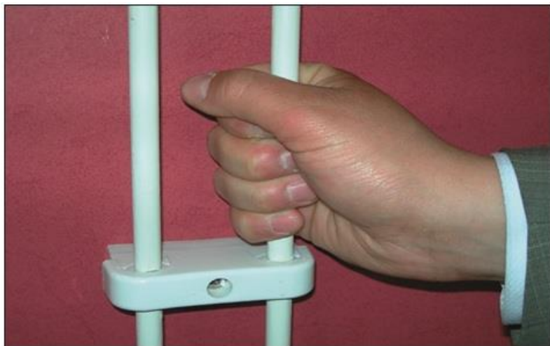
Рис. 26. Окрашенные медные трубы при подводке к отопительным приборам. Типичный наружный диаметр 12–15 мм
