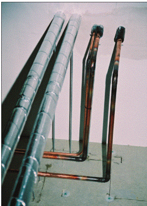
Рис. 27. Теплоизолированные(система отопления) не изолированные (система водоснабжения) медные теплопроводы в жилом здании
