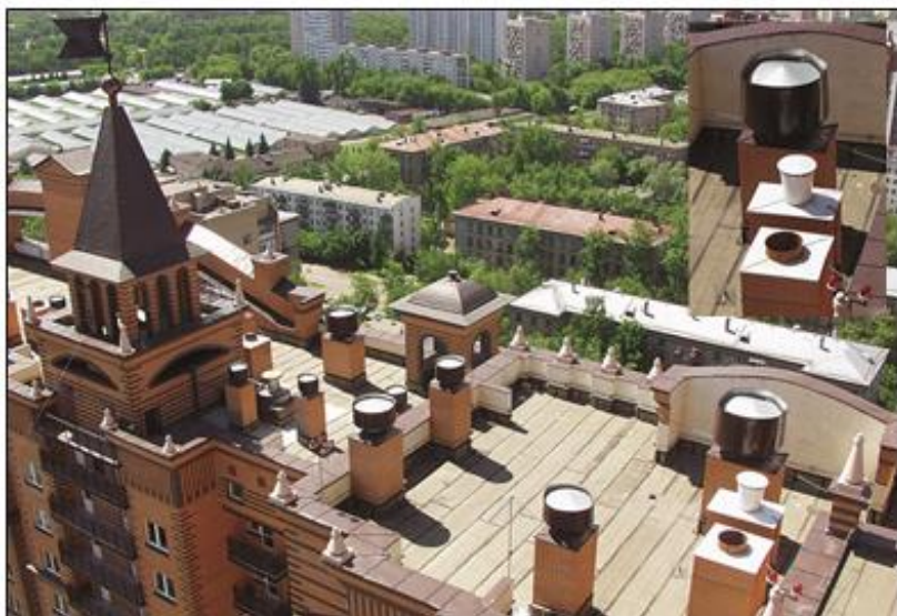
Рис. 32. Вытяжные крышные вентиляторы и дефлекторы на кровле здания в Тепличном пер.
