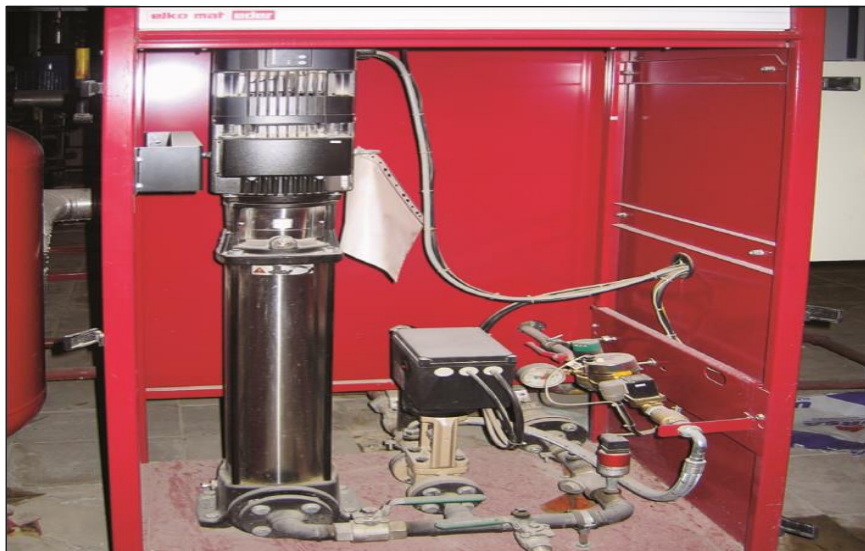
Рис. 14. Станция поддержания давления
