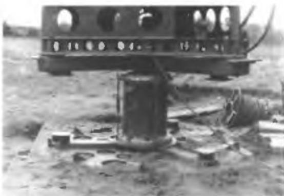
Рис.1.56. Установка ствола телескопической мачты высотой 52 метра на изолятор
