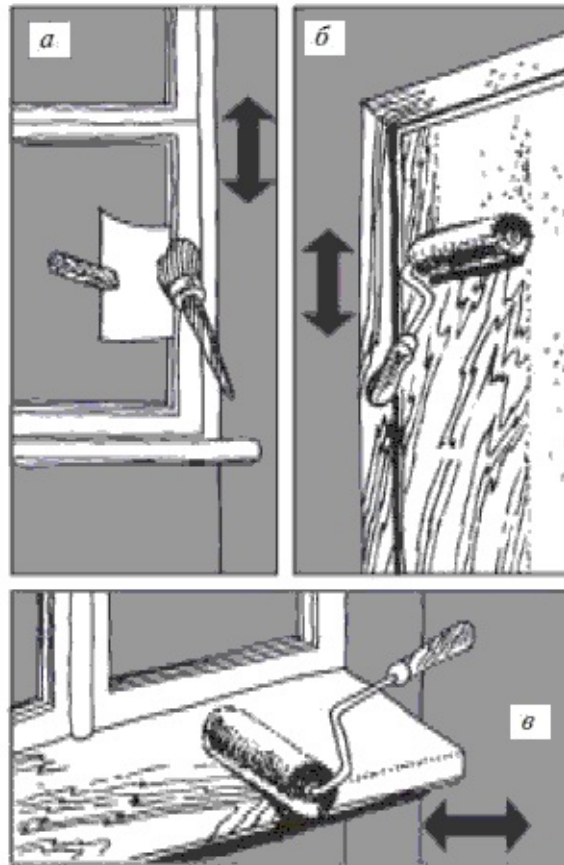
Рис. 166. Окраска столярных изделий: а – способ защиты стекла при нанесении окрасочного состава; б, в – применение валика для окраски дверного полотна и подоконной доски
