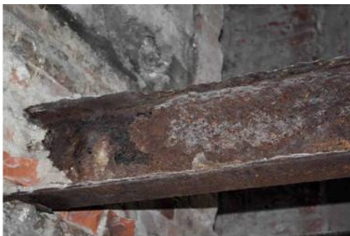
Рис. 3.12. Биоповреждение стальной балки
