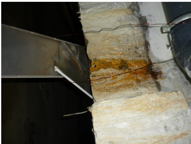
Рис. 3.5. Протечки железобетонной чаши бассейна являются следствием нарушения технологии устройства технологических швов при бетонировании
