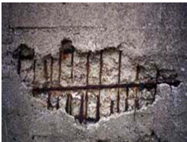
Рис. 2.3. Выбоины и углубления в бетоне
