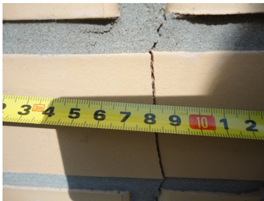
Рис. 3.6. Трещины в кирпичной кладке
