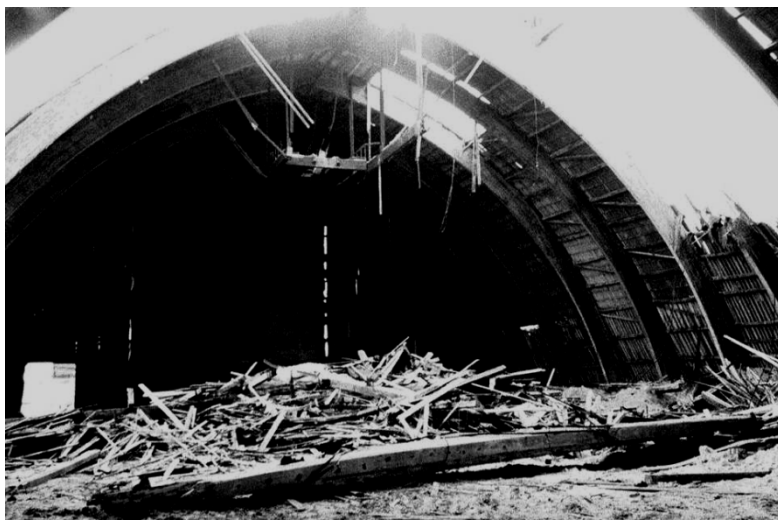
Рис. 3.14. Общий вид склада из клееных деревянных конструкций после аварии из-за сверхнормативной односторонней снеговой нагрузки
