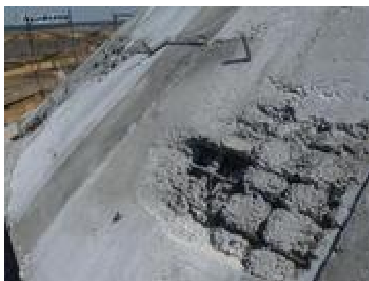
Рис. 2.14. Пустоты в бетонной конструкции, оголение арматурного каркаса
