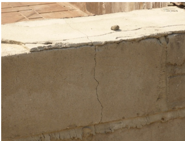
Рис. 2.4. Сквозная трещина в цокольной стене здания
