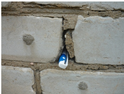
Рис. 3.7. Сквозные трещины по швам кирпичной кладки
