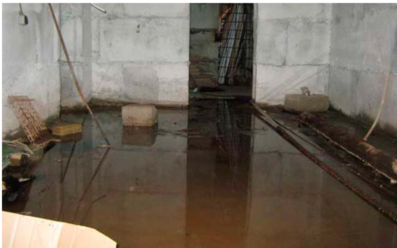
Рис. 2.12. Затопление подвала вследствие неправильного оборудования дренажной системы на этапе строительства
