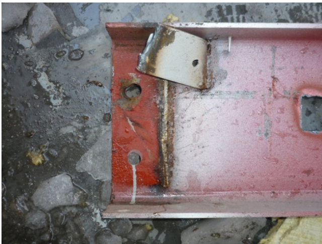
Рис. 3.11. Повреждения из-за некачественно выполненных сварных соединений
