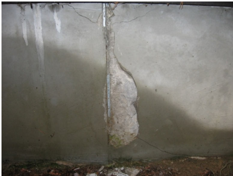
Рис. 2.9. Разрушение стен подвала вследствие систематических протечек
