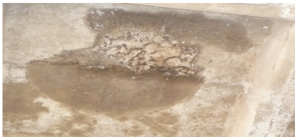
Рис. 3.2. Образование раковины при бетонировании
