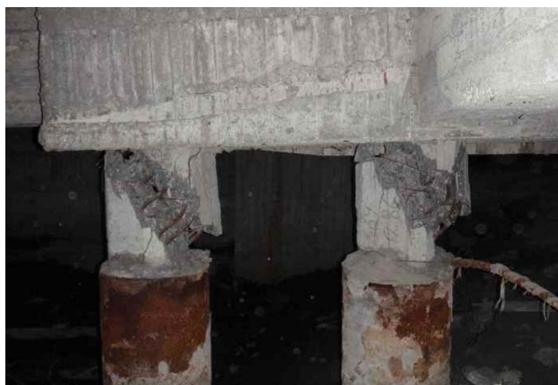
Рис. 2.5. Разрушение опорных частей столбчатого монолитного фундамента
