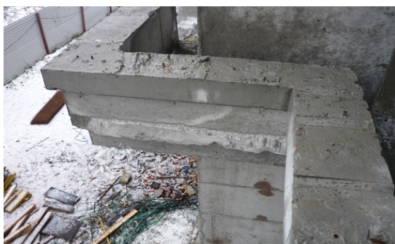
Рис. 3.3. Низкое качество бетонных работ
