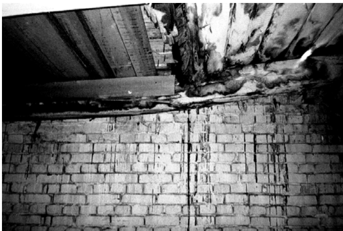
Рис. 3.13. Гниение и излом деревянных конструкций у торцовых стен зданий
