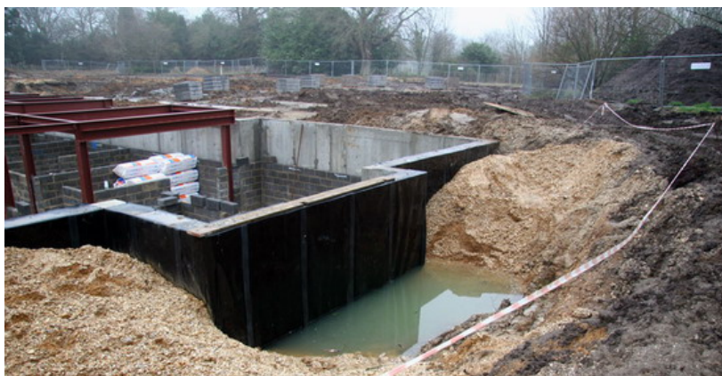
Рис. 2.8. Неправильный отвод грунтовых вод
