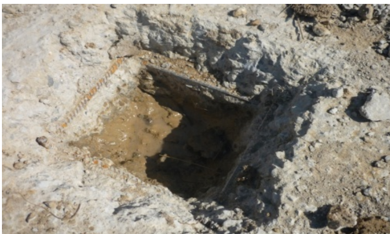
Рис. 2.15. Фундамент не имеет достаточной глубины заложения
