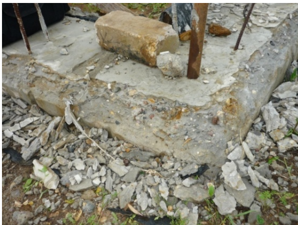
Рис. 2.6. Разрушение бетона по краям обреза фундамента
