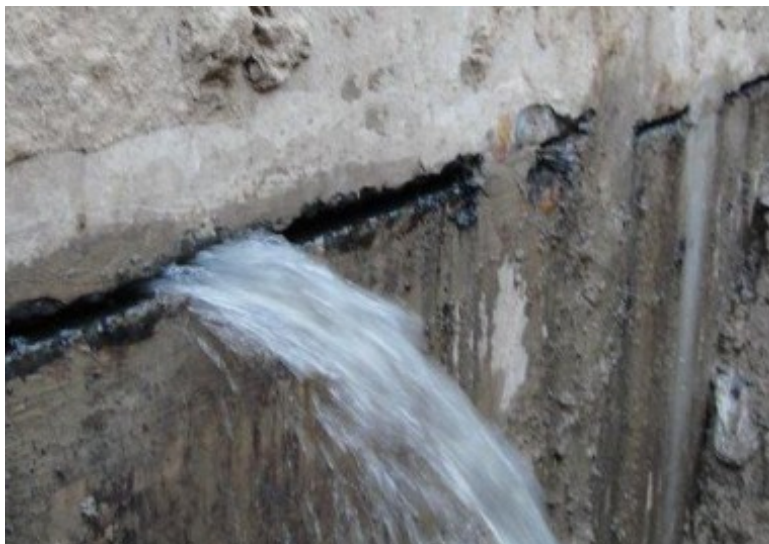
Рис. 2.10. Протечки грунтовых вод
